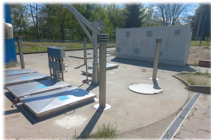
Przepompownia główna ścieków
